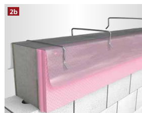
Die Folie auf der gedämmten Schalung mit den rekord Befestigungsbügeln befestigen bis der Beton vollständig ausgehärtet ist.
