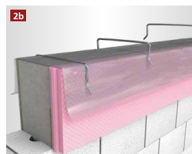
Die Folie auf der gedämmten Schalung mit den rekord Befestigungsbügeln befestigen bis der Beton vollständig ausgehärtet ist.
